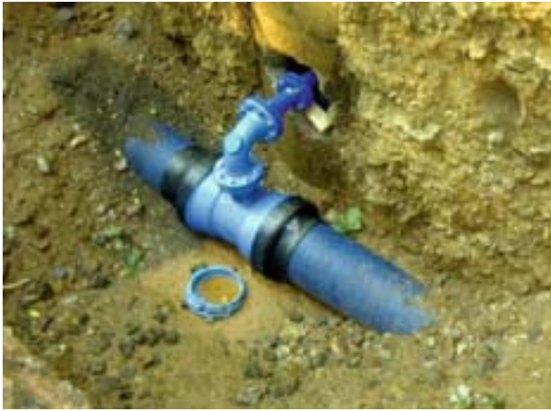
Bild 5: Abzweig zur Belüftung
