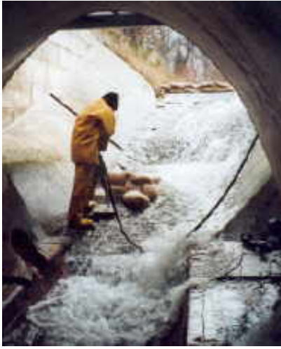
Der Gablenzbach soll durch das eingezogene Rohr aus dem Mischwasserkanal ausgegrenzt werden.
